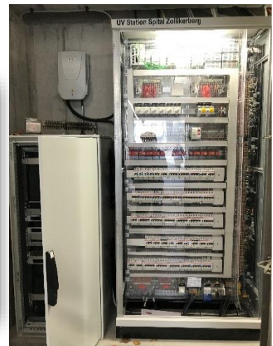
6. Unterverteilung mit 19"-Rack
